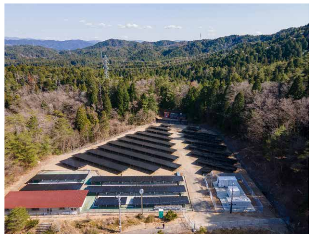
恵那電力の吉田発電所では、太陽光発電設備とNAS電池によって地域内に電力を供給。電気の地産地消を実現する地域マイクログリッドの構築を目指し、実証・運用を進めている
