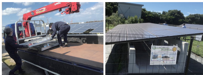
左:福岡県では廃太陽光パネルのスマート回収のための仕組みを構築。その回収実証の様子。右:北九州市のリユースパネルによる発電実証
